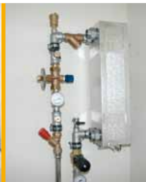
Die Übergabestation mit Wärmetauscher in den Häusern - mehr wird nicht benötigt.
